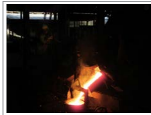
高周波電気炉設備です。
