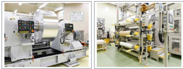
クリーンルーム内大型金属箔スリッター 高圧連続熱ラミネート装置
